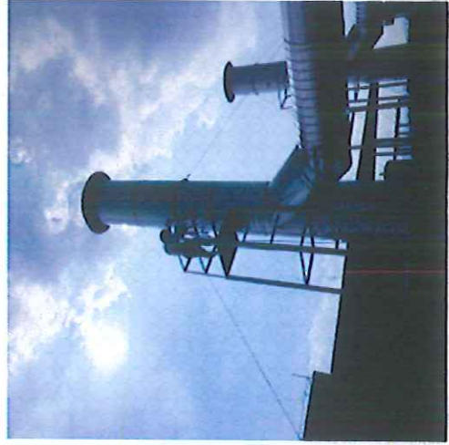
五楼 1 号线废气
